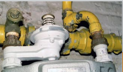
Potenzielle Gefahr im Haus: Herkömmliche Gasverteiler aus Stahl rosten und werden dadurch mit der Zeit undicht.
